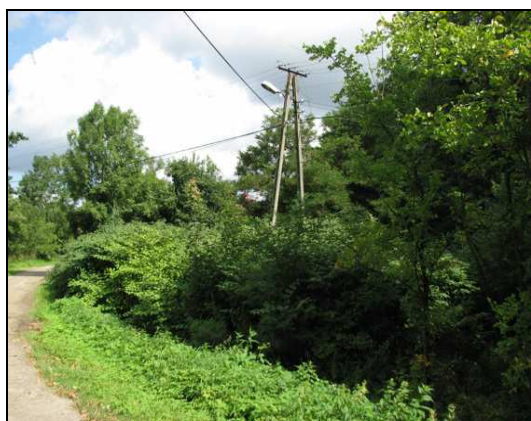
Fot.21. Linia niskiego napięcia w miejscowości Wiewiórka.
