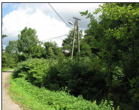
Fot.21. Linia niskiego napięcia w miejscowości Wiewiórka.
